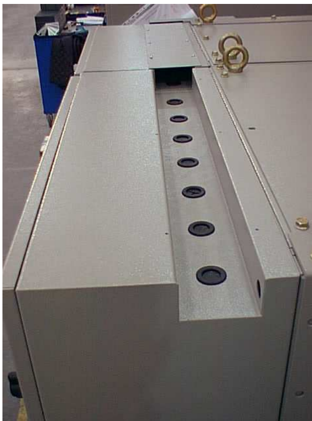
Fot. 8 – widok kanału kablowego na dachu rozdzielnicy SN
